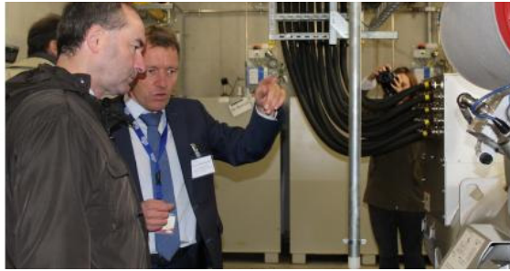
Markus Brautsch (2.v.l.), Professor an der OTH Amberg, erklärt Bayerns Wirtschaftsminister Hubert Aiwanger die KWKK-Anlage bei der Meistermetzgerei Ponnath im oberpfälzischen Kemnath Bild: E&M, Heidi Roider
