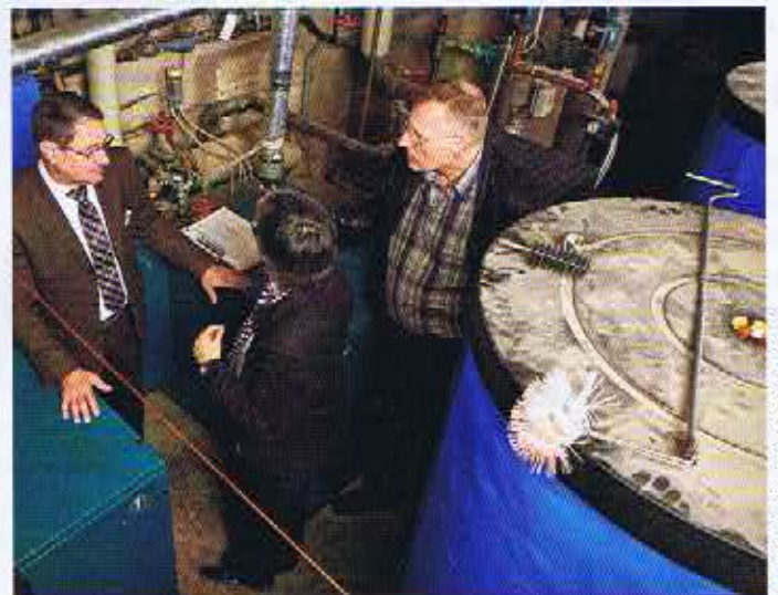
Rein in den Keller, vor Ort informieren: Das ist das Motto der Veranstaltungen der Reihe KWK.NRW-vor-Ort, die jetzt erstmals im Hotel Lippeschlösschen durchgeführt wurde. Moderne Energietechnik mit Blockheizkraftwerken steht dabei im Mittelpunkt und soll Gastronomen und Hotellers Ansatzpunkte für modernes und sparsames Energiemanagement liefern.
