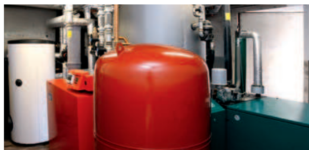
Modernste Technik mit Contracting: Ohne eigene Investitionskosten versorgen die Gasbrennwertanlage (vorne links, rot) und das BHKW (vorne rechts, grün) für einen monatlichen Grundbetrag den Betrieb.
